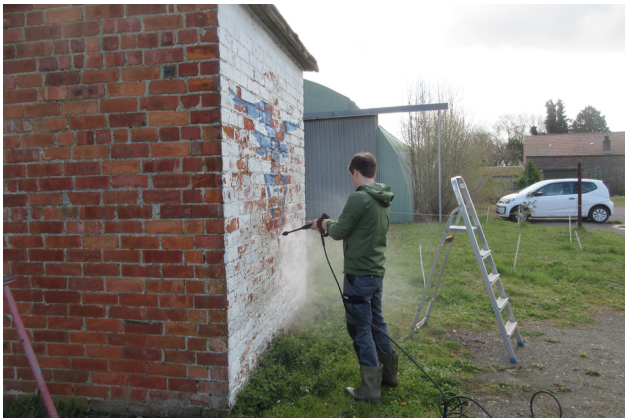
DENNIS BIJ HET KUISEN VAN DE OUDE ELEKTRICITEITSCABINE
